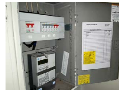
Automatsikringer i sikringsskap plassert i gang/fellesareal.
