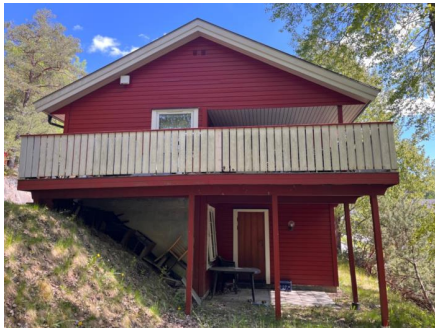
Skjevheter på gulvkonstruksjonen.
