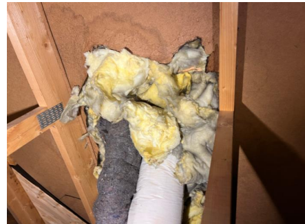
Undertaket er ikke fagmessig tettet rundt luftehatt.
