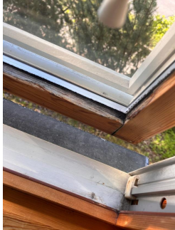
Vindu på kjøkken, begynnende råteskade.
