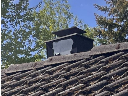
Maling har løsnet på pipe beslaget.
