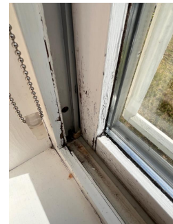
Vindu på soverom 1 etasje, begynnende råteskade.
