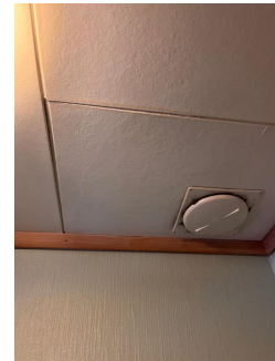
Fuktsvelling på himlingsplate i toalett rom.
