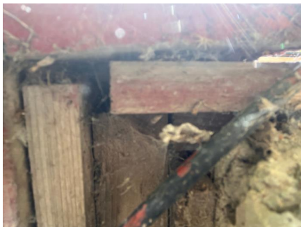
Åpning hvor mus kan komme inn bak kledningen, hjørne sørvest.
