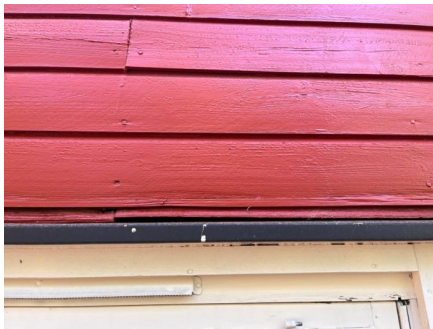
Råte på kledning, vestvegg
