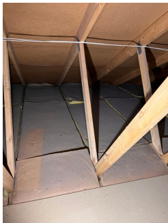
Det er ikke laget luftespalte på rafter.
