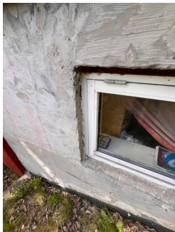
Vinduer i mur er ikke ferdig innpusset.
