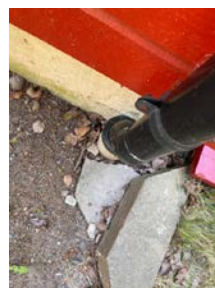
Ikke synlig vorteplast/fuktsikring. N/V hjørne
