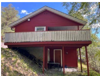
Skjevheter på gulvkonstruksjonen.
