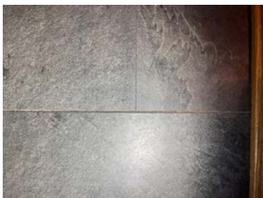
Sprekk i skjøt på laminat i vindfang.
