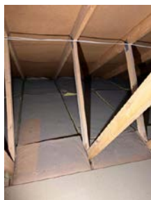
Det er ikke laget luftespalte på rafter.
