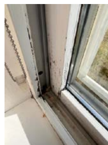
Vindu på soverom 1 etasje, begynnende råteskade.
