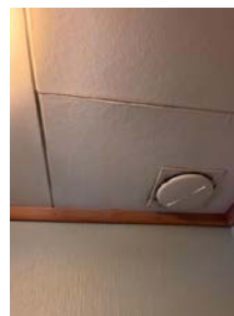
Fuktsvelling på himlingsplate i toalett rom.
