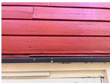
Råte på kledning, vestvegg
