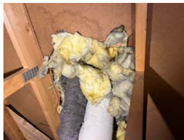
Undertaket er ikke fagmessig tettet rundt luftehatt.
