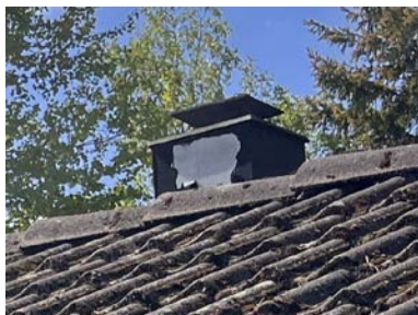
Maling har løsnet på pipe beslaget.
