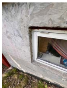
Vinduer i mur er ikke ferdig innpusset.
