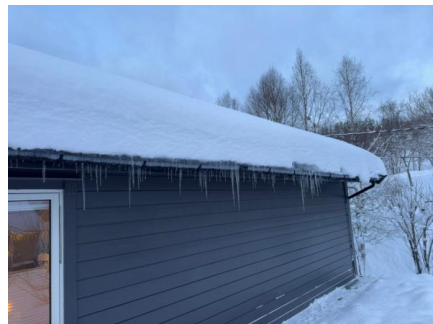
Isdannelse ved takfoten.
