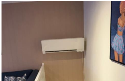
Varmepumpe montert i stuen.
