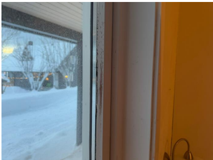
Innvendig skade etter katt.
