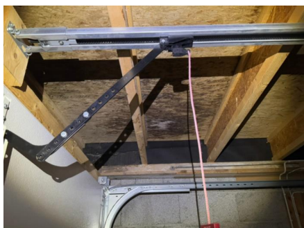
Fuktskjolder i taktroplater.
