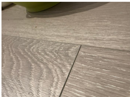
Svelling i skjøt på gulvet.
