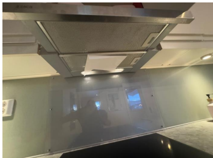
Funksjonstest av avtrekksvifte.
