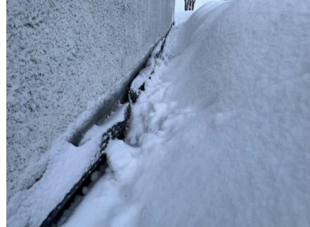
Eksempel på løs fuktsikring på grunnmuren.
