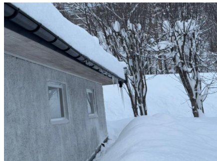
Nedbøyning på takrennen til garasjen.
