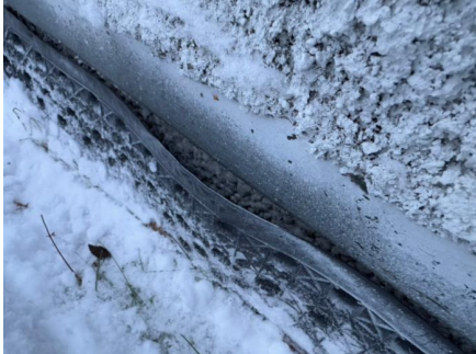
Eksempel på løs fuktsikring på grunnmuren.
