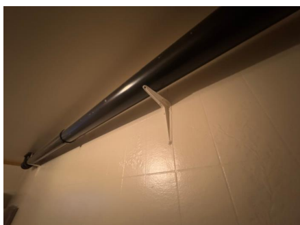
Ufagmessig utførelse av klamring av avløpsrør.
