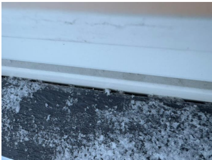
Åpning mellom vindu og vannbrett.
