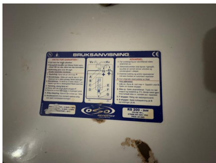
Produksjonsdato på varmtvannsberederen.
