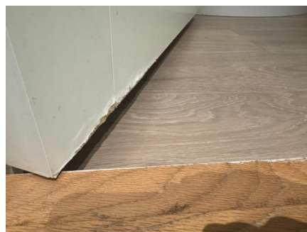
Fuktskader på dør mot badet.
