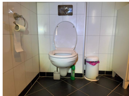
Manglende synliggjøring av lekkasjevann fra innebygd sisterner.
