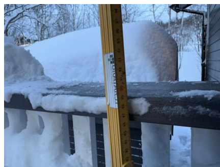
Rekkverk er for lavt ift. regelverket på oppføringstidspunktet.
