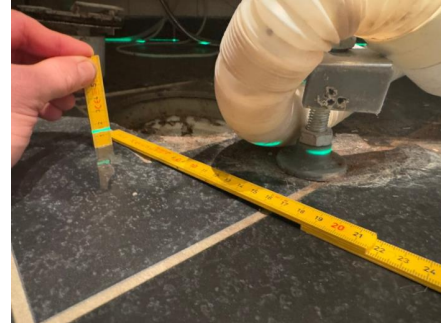
Måling ved sluken under badekaret.
