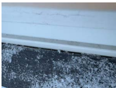
Åpning mellom vindu og vannbrett.
