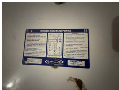
Produksjonsdato på varmtvannsberederen.
