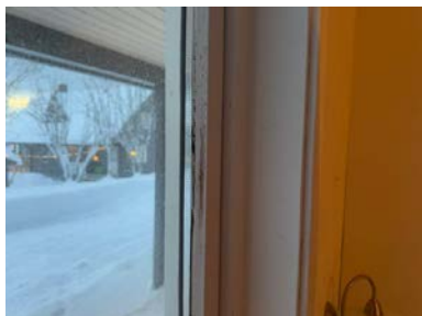
Innvendig skade etter katt.
