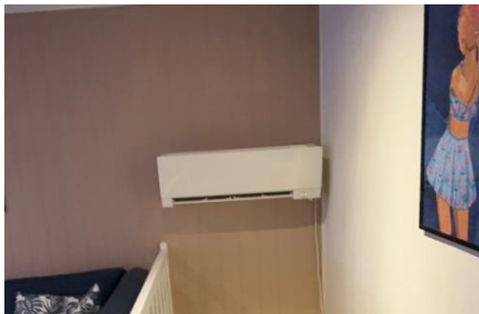
Varmepumpe montert i stuen.
