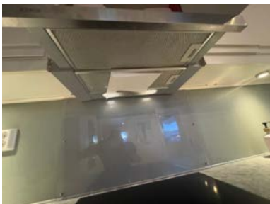
Funksjonstest av avtrekksvifte.
