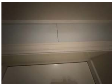
Eksempel på skade som er utover hva man kan forvente.
