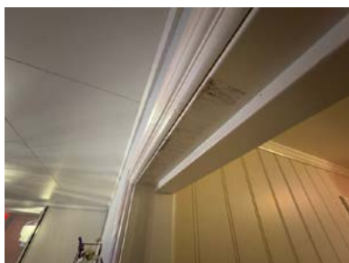
skader i karm etter kleshenger på dør.
