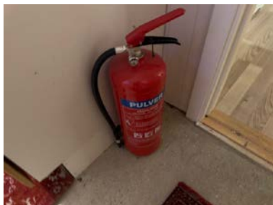
Håndslukker datert til 2020.
