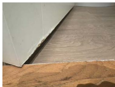
Fuktskader på dør mot badet.
