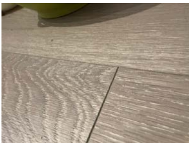
Svelling i skjøt på gulvet.
