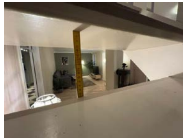
For stor åpning mellom trinn i innvendig trapp
