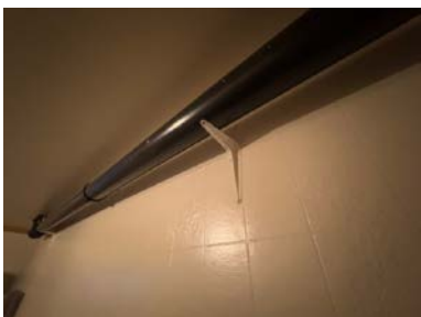
Ufagmessig utførelse av klamring av avløpsrør.
