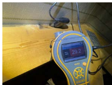
Fuktmåling i svertesopp på taksperran.
