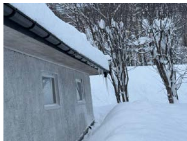
Nedbøyning på takrennen til garasjen.
