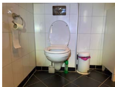
Manglende synliggjøring av lekkasjevann fra innebygd sisterner.
