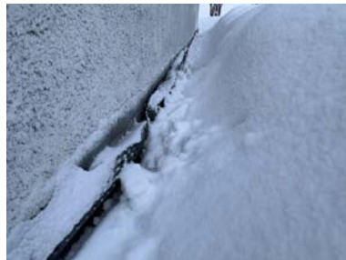
Eksempel på løs fuktsikring på grunnmuren.
