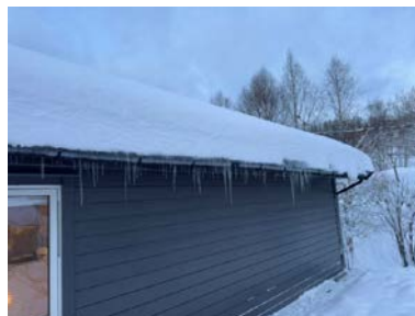
Isdannelse ved takfoten.
