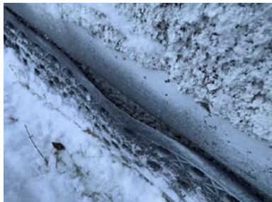
Eksempel på løs fuktsikring på grunnmuren.
