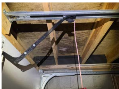
Fuktskjolder i taktroplater.
