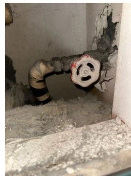
Stoppekraner plassert i luke på wc.
