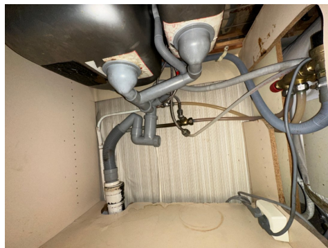
Røropplegg i kjøkkenbenk
