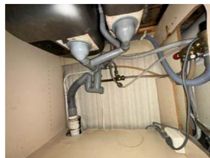
Rørapplegg i kjøkkenbenk
