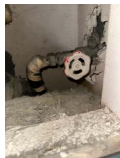
Stoppekraner plassert i luke på wc.
