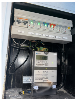
Sikringsskap plassert i felles oppgang.
