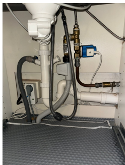
Røropplegg i kjøkkenbenk med Waterguard
