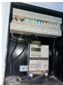
Sikringsskap plassert i felles oppgang.
