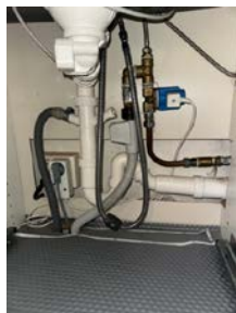
Røropplegg i kjøkkenbenk med Waterguard
