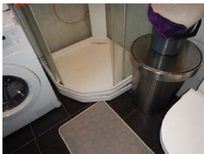
Sluk er plassert under dusjkabinett
