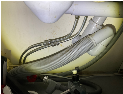
Mindre drypp fra kobling
