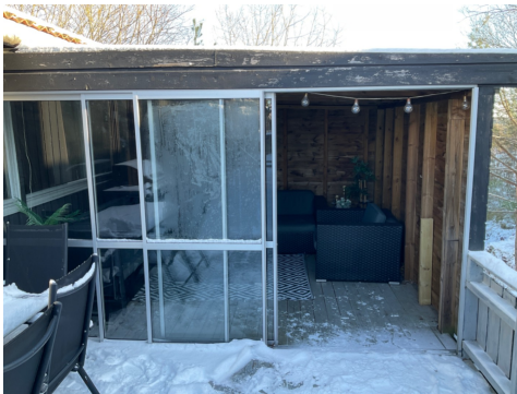
Skyvedører var frosset og ble ikke testet ved befaringen
