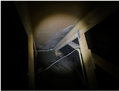
Fuktskjolder ut mot gavlvegg hageside
