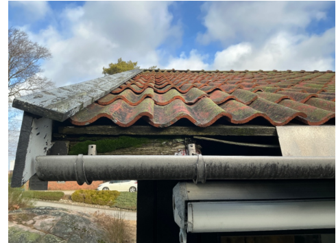
Område med lokal skade og manglende beslag
