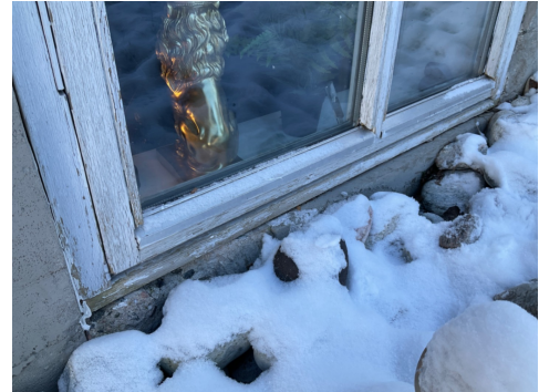
Manglende tetting rundt vinduer i murvegg.
