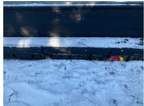
Råteskade i treverk under skyvedør
