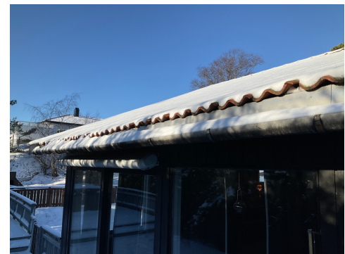
Ujevn og stedvis manglende fall på takrenner
