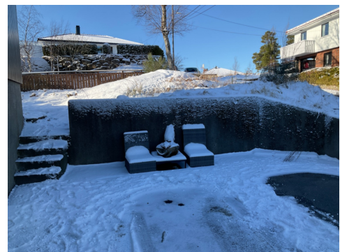
Manglende sikring på topp av mur
