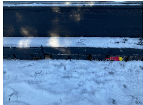
Råteskade i treverk under skyvedør
