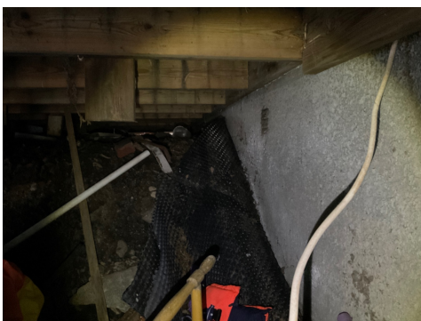
Synlig grunnmursplast, men ikke avsluttet og tett mot vegg
