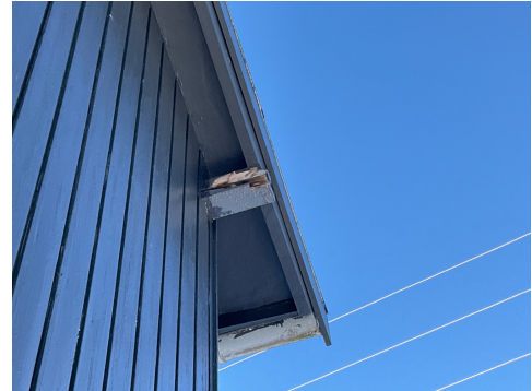
Råteskade i ustikk på gavlvegg
