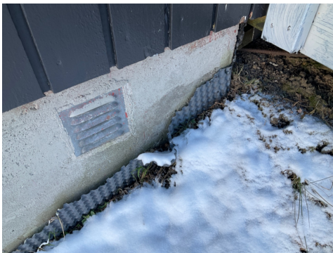
Mangelfull avslutning på grunnmursplast mot vegg
