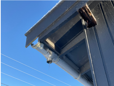
Manglende endelokk på takrenner
