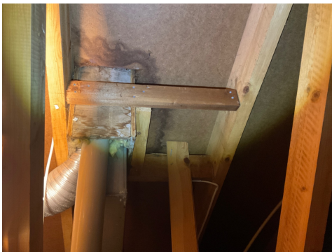
Fuktskjolder ved gjennomføring av tak.
