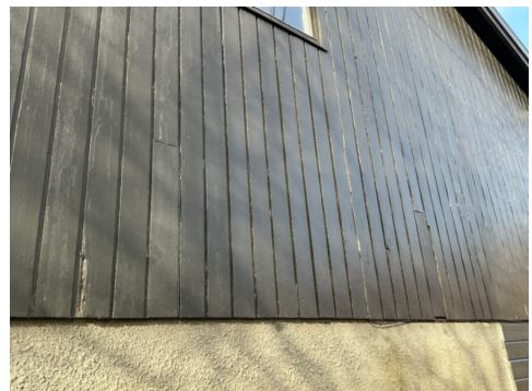
Sporadisk råteskade i bord på endevegg
