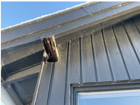
Råteskade i ustikk på gavlvegg
