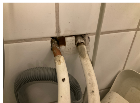
Utette gjennomføringer i vegg
