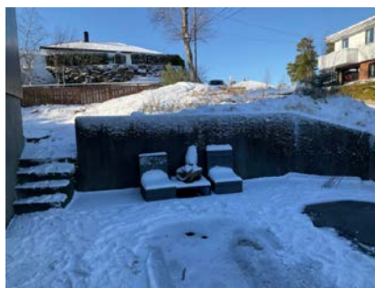
Manglende sikring på topp av mur
