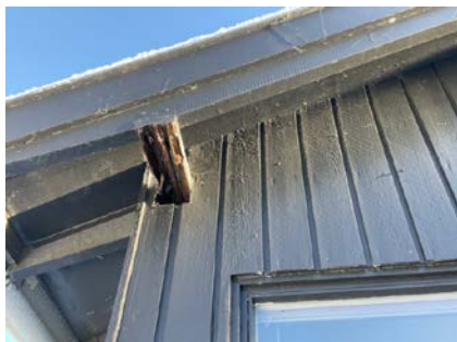
Råteskade i ustikk på gavlvegg
