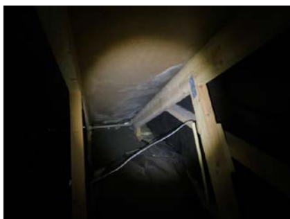
Fuktskjolder ut mot gavlvegg hageside
