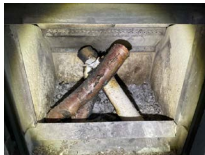
Slitasje inne i vedovn
