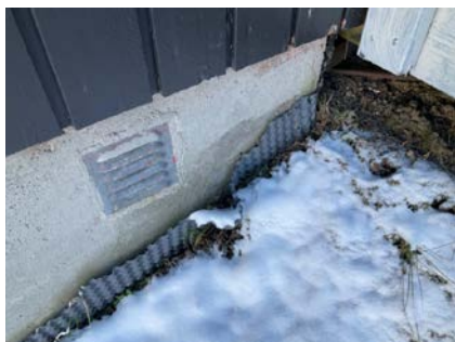
Mangelfull avslutning på grunnmursplast mot vegg
