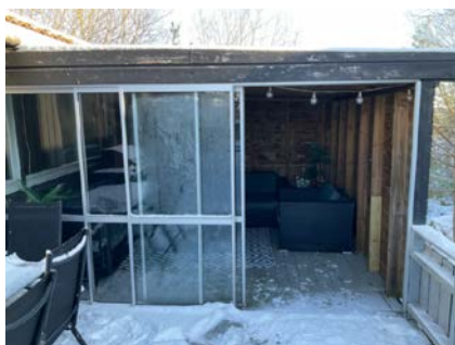
Skyvedører var froset og ble ikke testet ved befaringen
