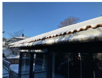
Ujevn og stedvis manglende fall på takrenner
