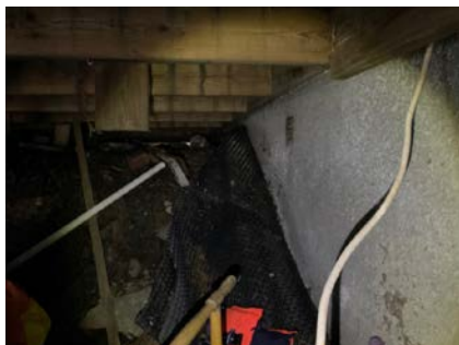
Synlig grunnmursplast, men ikke avsluttet og tett mot vegg
