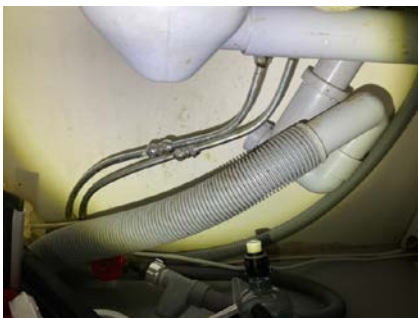
Mindre drypp fra kobling
