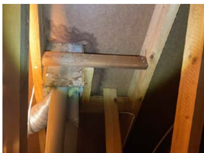
Fuktskjolder ved gjennomføring av tak.
