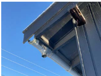
Manglende endelokk på takrenner
