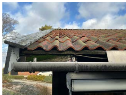
Område med lokal skade og manglende beslag
