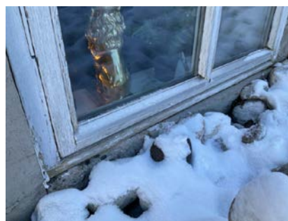
Manglende tetting rundt vinduer i murvegg.
