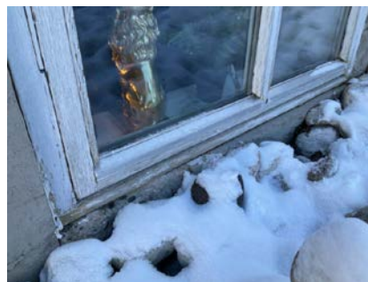
Manglende tetting rundt vinduer i murvegg.
