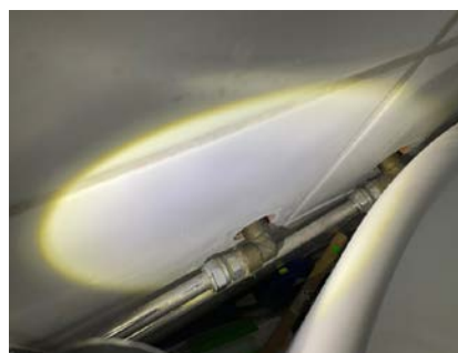
Gjennomføringer ser ut til å mangle tilstrekkelig tetting.
