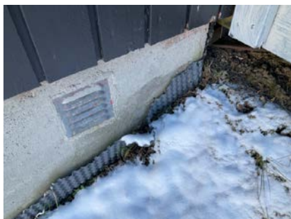
Mangelfull avslutning på grunnmursplast mot vegg
