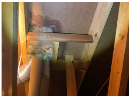
Fuktskjolder ved gjennomføring av tak.
