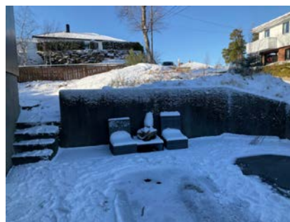
Manglende sikring på topp av mur
