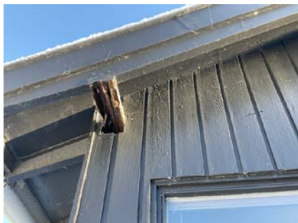
Råteskade i ustikk på gavlvegg
