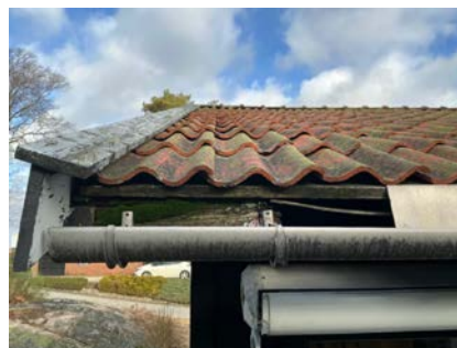
Område med lokal skade og manglende beslag
