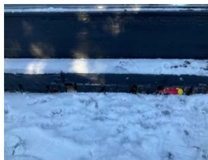
Råteskade i treverk under skyvedør
