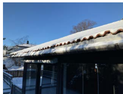
Ujevn og stedvis manglende fall på takrenner
