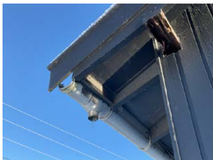
Manglende endelukk på takrenner
