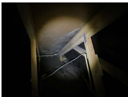
Fuktskjolder ut mot gavlvegg hageside
