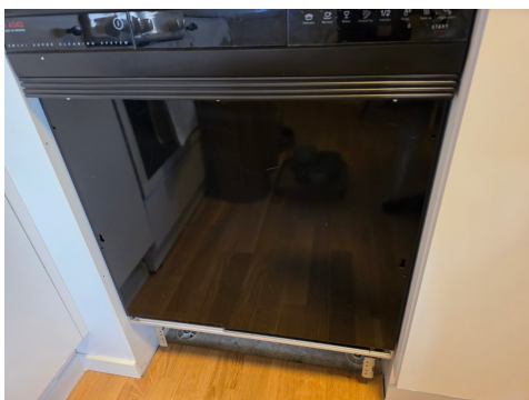
Det mangler front og sokkel på oppvaskmaskin
