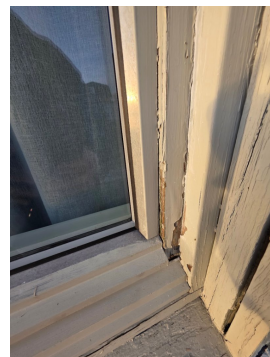
Værslitasje på enkelte vinduer
