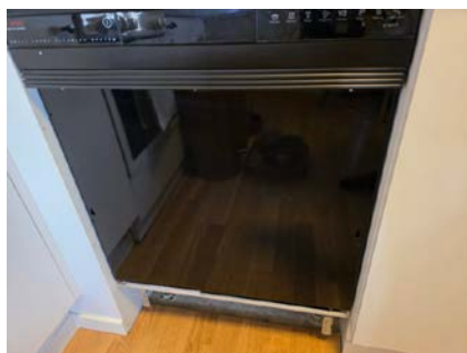
Det mangler front og sokkel på oppvaskmaskin
