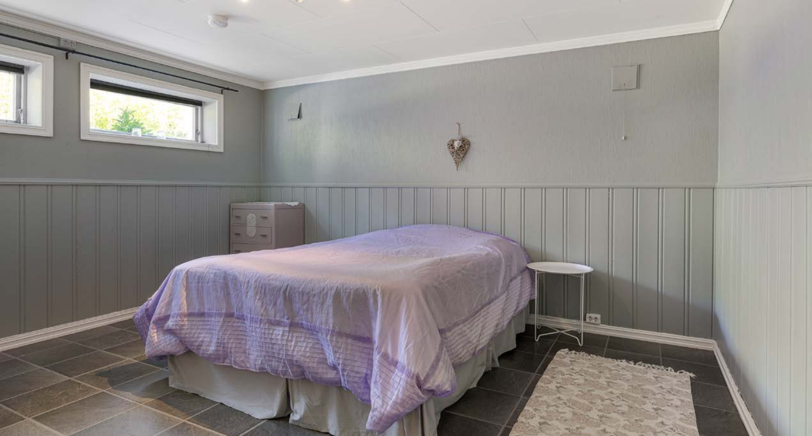
Dette innredede rommet er tatt i bruk som soverom og har to høysittende vinduer. Rommet er ikke godkjent som oppholdsrom og er benevnt som disponibelt på byggetegninger.
