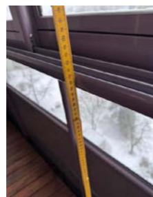
Høyden på rekkverket er 110 cm, mens dagens krav er 120 cm
