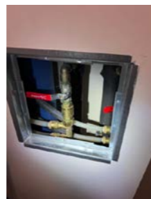
Stoppekraner er tilgjengelig i boden i leiligheten.
