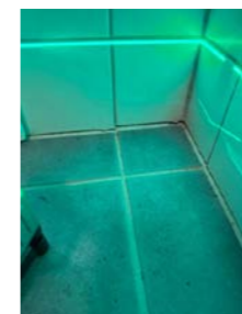
Fugemassen mellom gulv og vegg har sluppet enkelte steder.
