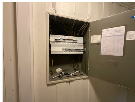
Sikringsskap i felles trappegang
