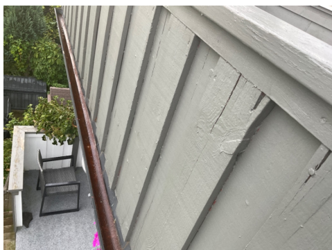
Sprukket treverk på balkongrekkverk
