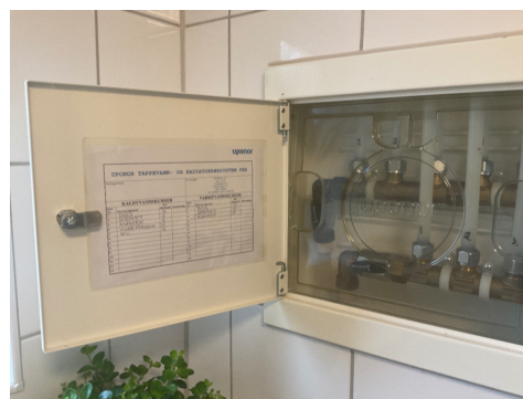
Rør i rør skap på baderom
