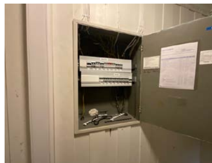
Sikringsskap i felles trappegang
