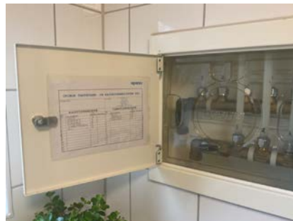
Rør i rør skap på baderom
