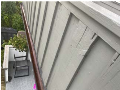
Sprukket treverk på balkongrekkverk
