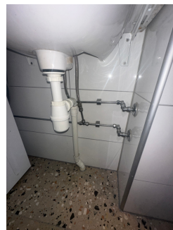
Rørøpplagg under servant på bad
