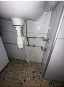
Rørøppløp under servant på bad
