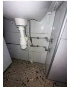
Rørøpplagg under servant på bad
