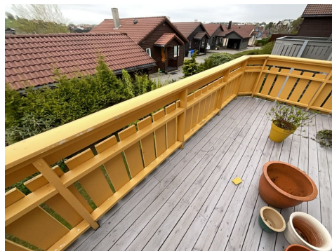
Rekkverk på terrasse er lavere enn 1m som er krav til høyde i dagens forskrifter.
