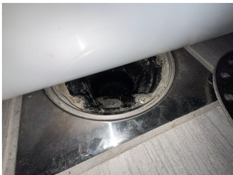
Sluk i gulv, uten synlig membran.
