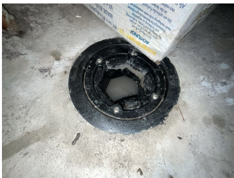
Sluk i gulv i vaskerom.
