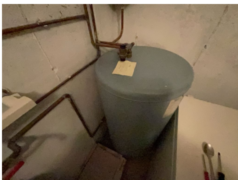
Varmtvannstank fra byggeåret, eldre enn 20 år.
