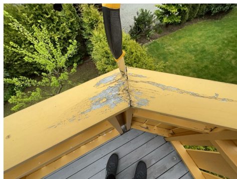
Råte i skjøt av topprekke på rekkverk.
