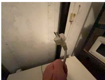
Kontakt til varmtvannstank er delvis smeltet.
