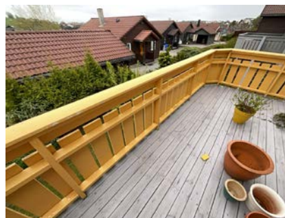
Rekkverk på terrasse er lavere enn 1m som er krav til høyde i dagens forskrifter.
