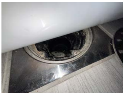
Sluk i gulv, uten synlig membran.
