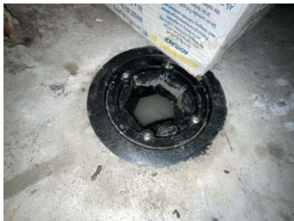
Sluk i gulv i vaskerom.
