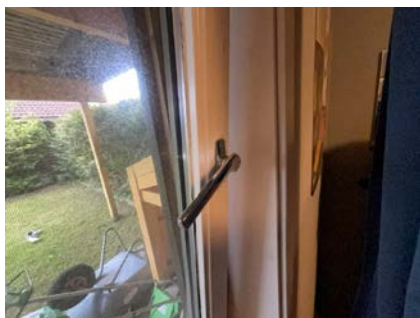
Defekt vridning til vindu i soverom.
