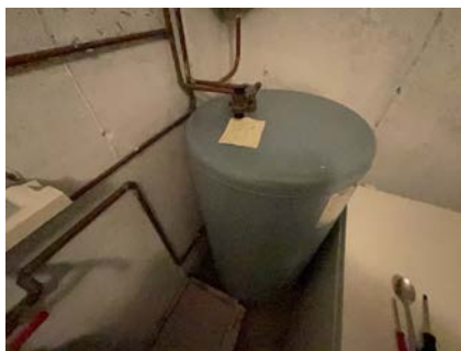
Varmtvannstank fra byggeåret, eldre enn 20 år.
