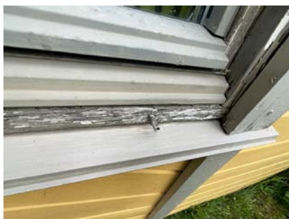
Nedbrytning og værslitasje i utvendig karm til vindu mot soverom.
