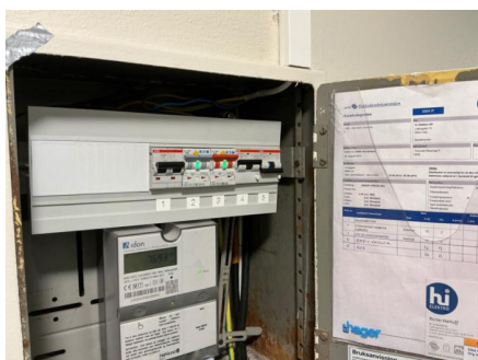
Automatsikringer i sikringsskap plassert i gang/ fellesareal.
