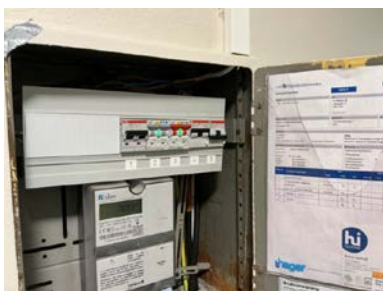
Automatsikringer i sikringskap plassert i gang/ fellesareal.
