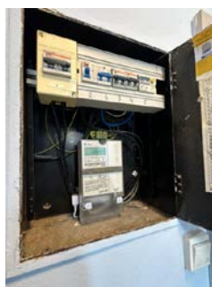
Sikringsskap med automatsikringer.
