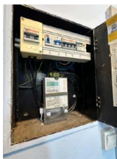
Sikringsskap med automatsikringer.
