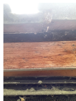
Mnaglende lufting bak kledning.
