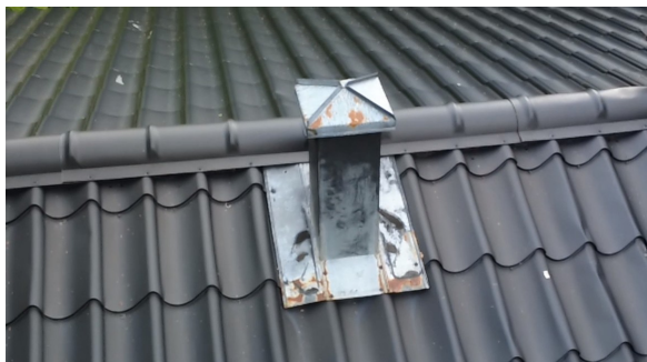
Rust på luftehatt.
