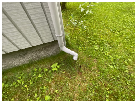
Enkelte nedløp mangler kontrollert avrenning.
