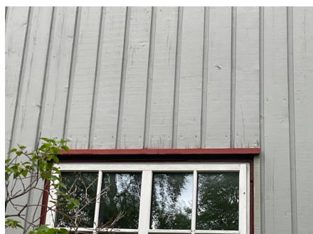
Oppsprekk av kledning over vindubeslag og værutsatte vegger.
