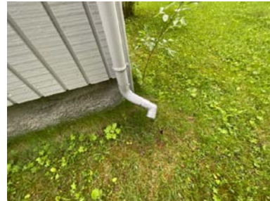
Enkelte nedløp mangler kontrollert avrenning.
