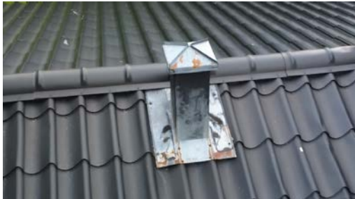
Rust på luftehatt.
