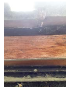
Manglende lufting bak kledning.
