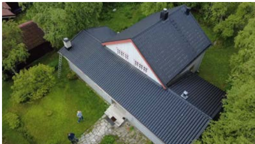
Manglende snøfangere rundt om boligen
