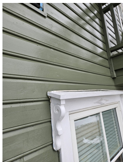
Vindu med manglende overliggende beslag
