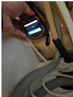
Overflatesøk på gipsplate uten utslag.
