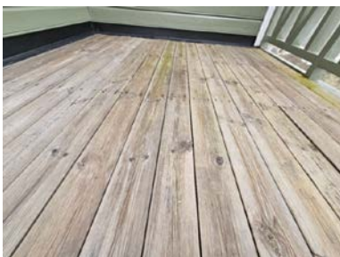
Spaltegulv på balkong.
