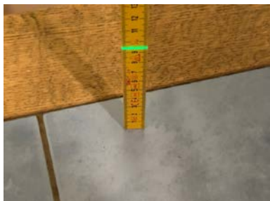
Fallforhold ca. 95 mm overkant gulv ved terskel
