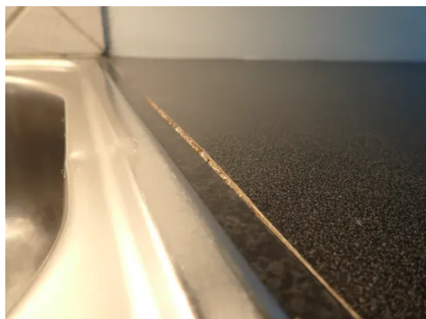
Svelling i skjøt på beneplate.
