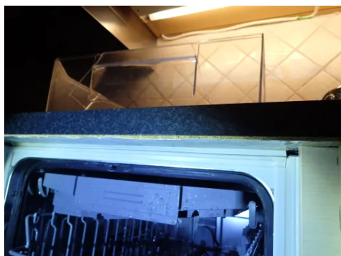
Svelling/fuktskade i underkant benkeplate ved oppvaskmaskin.
