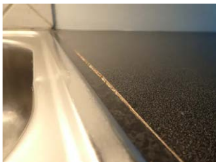
Svelling i skjøt på beneplate.
