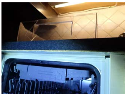
Svelling/fuktskade i underkant benkeplate ved oppvaskmaskin.
