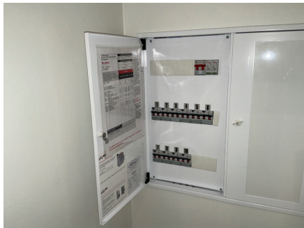
Automatsikringer i sikringsskap plassert i gang.
