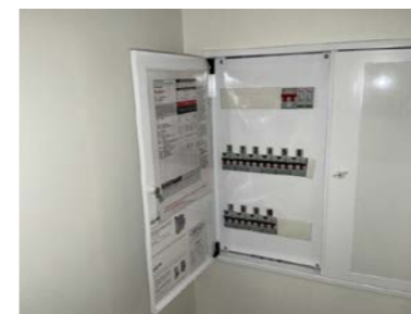
Automatsikringer i sikringsskap plassert i gang.
