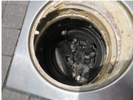
Skade på sluk. Manglende sluk-potte.
