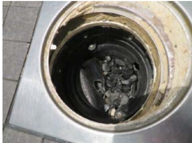
Skade på sluk. Manglende sluk-potte.
