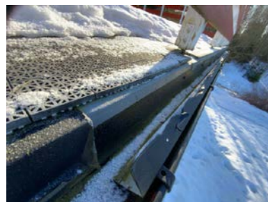
Beslag har løssnet som beskytter membran i enden ved takrenne
