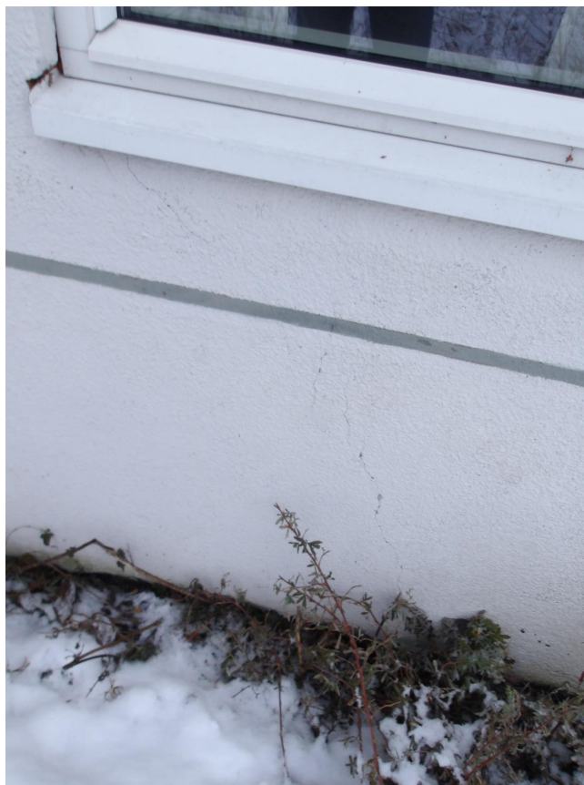
Sprekker i mur
