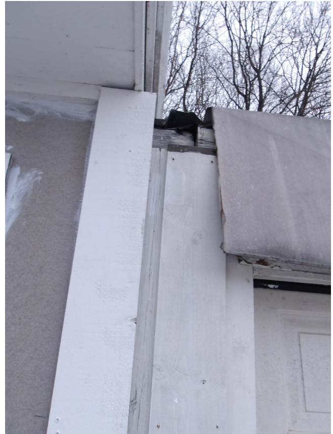
Mangler noe beslag
