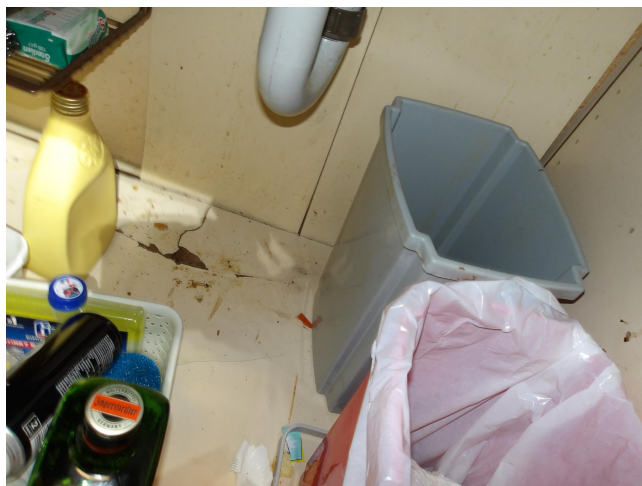
Skade i benk.
