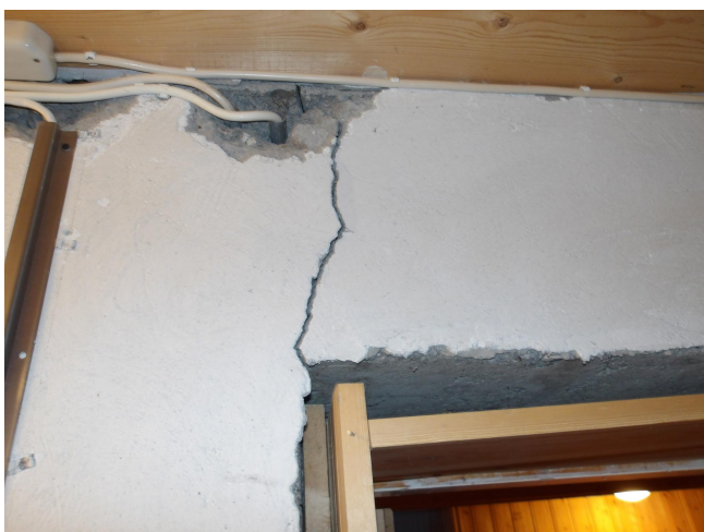
Skader på ytterveggen.
