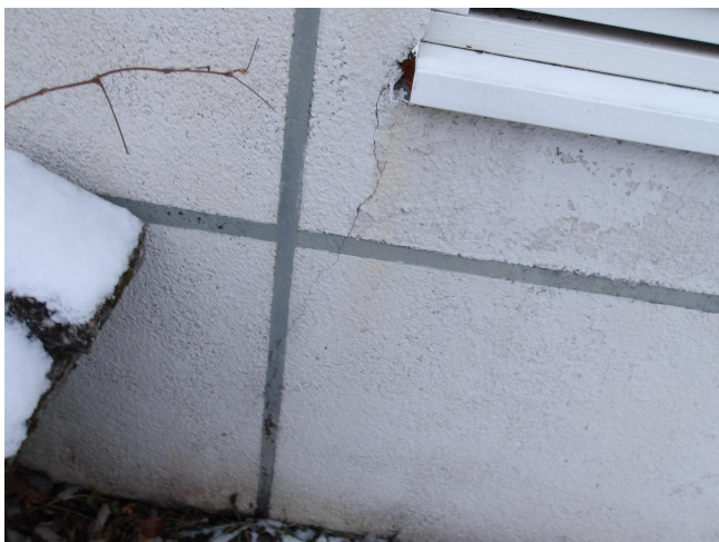
Sprekker i mur.
