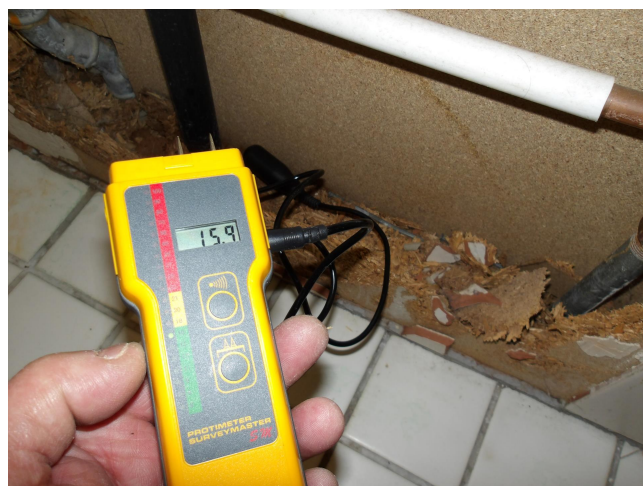
Fuktmåling på baksiden av vaskeservan
