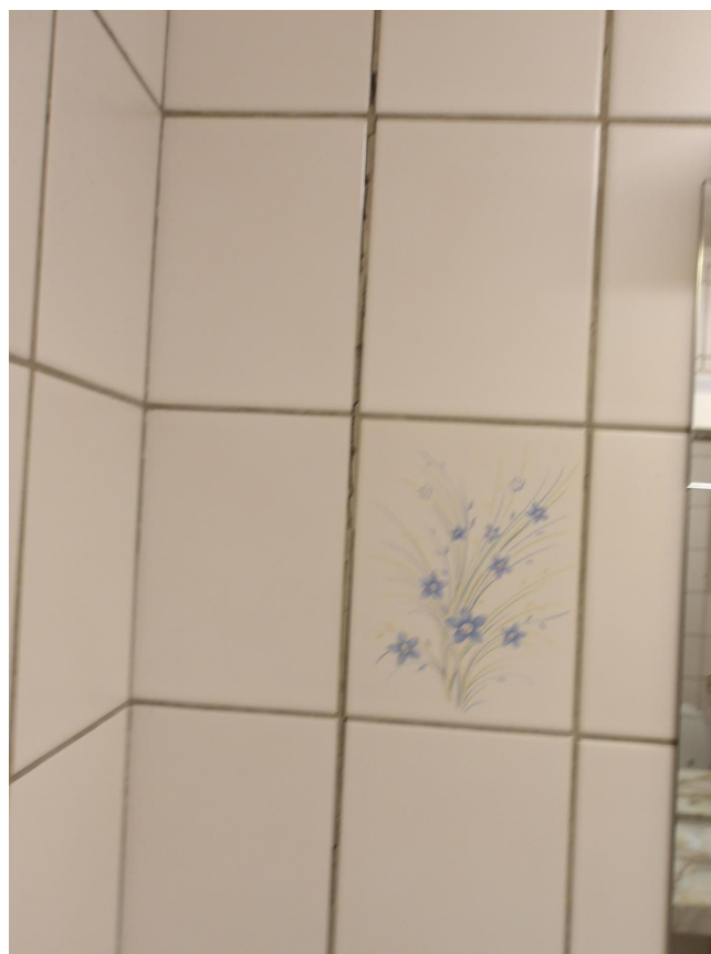
Sprekker i fuger
