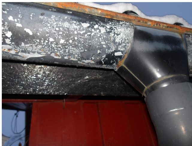
Noe rust på renner.
