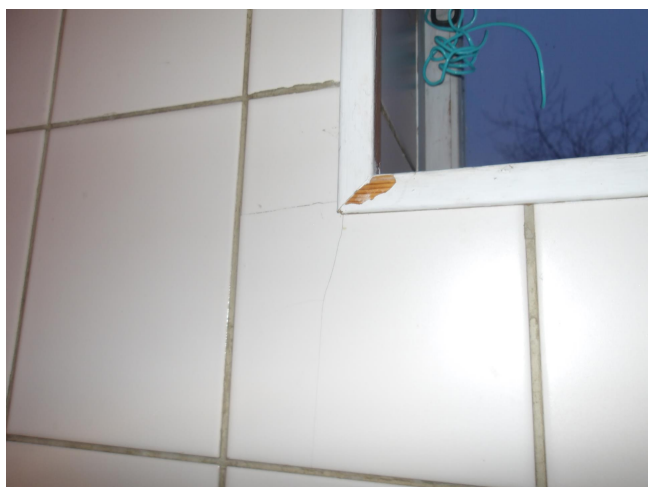
Sprekker i flis
