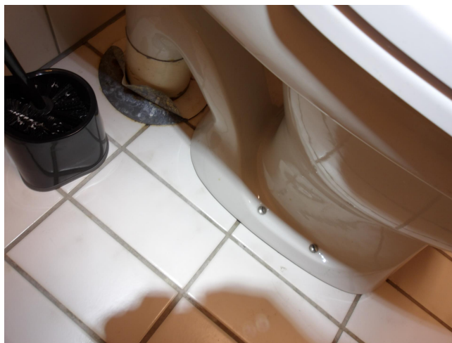
Krage rundt toalettavløpet har skader.
