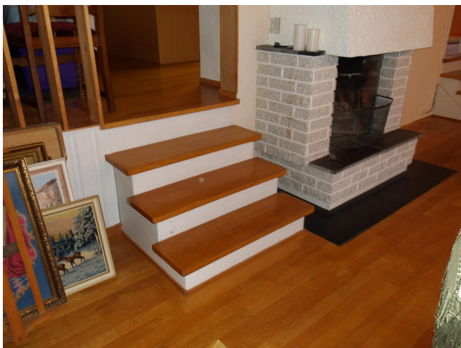
Innvendig trapp mangler rekkverk.
