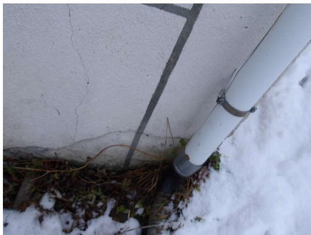
Sprekker og avskalling av mur.
