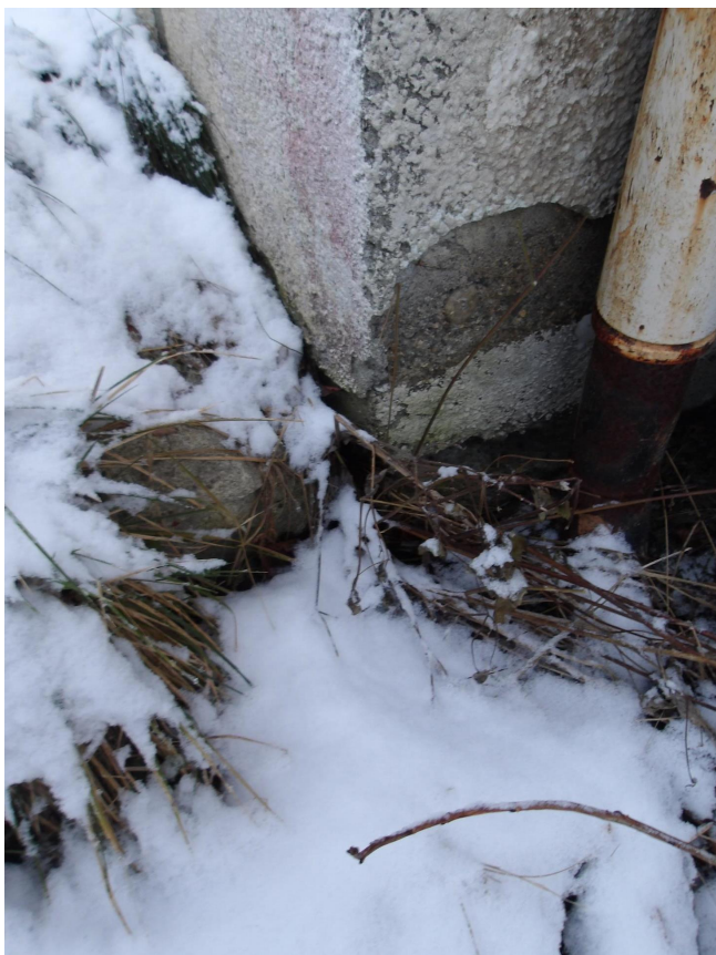
Avskalling av mur/pus
