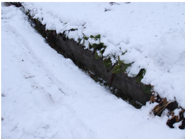
Mur er skadet og skjev.
