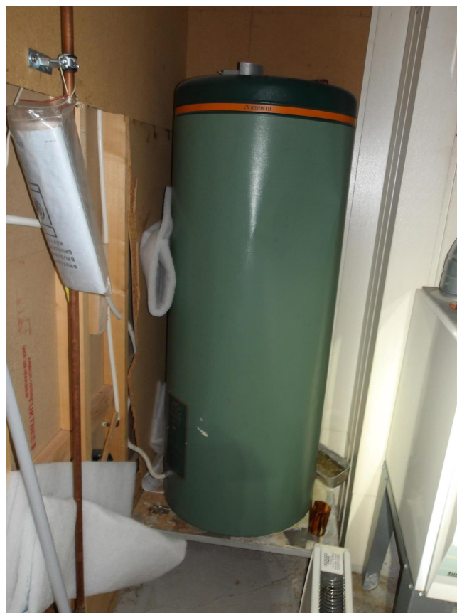
200 l varmtvannstank. Ukjent produksjonsår.
