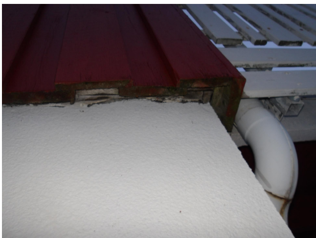
Råte i nedre kant av kledning.
