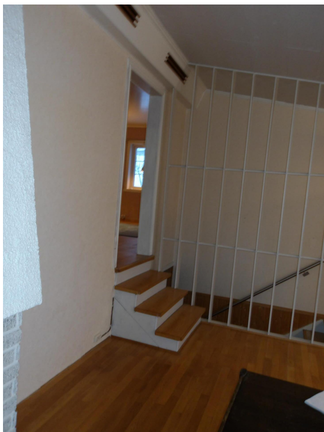
Innvendig trapp mangler rekkverk, samt at det er trestaver mot trappen.
