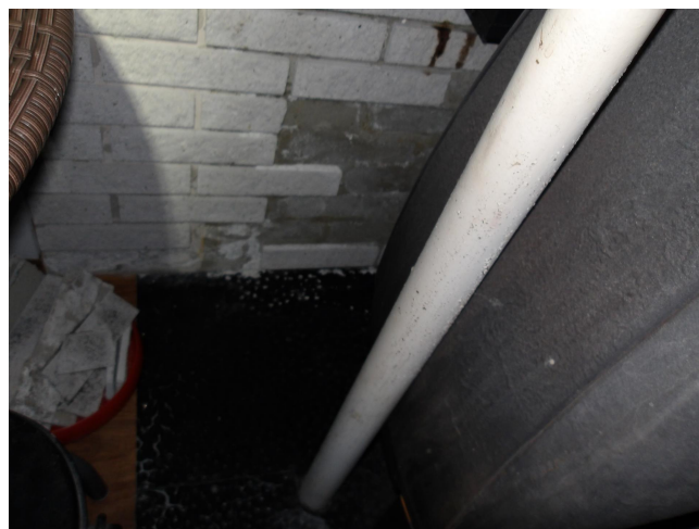
Forblendingsstein bak ildstedet i kjeller har løsnet.
