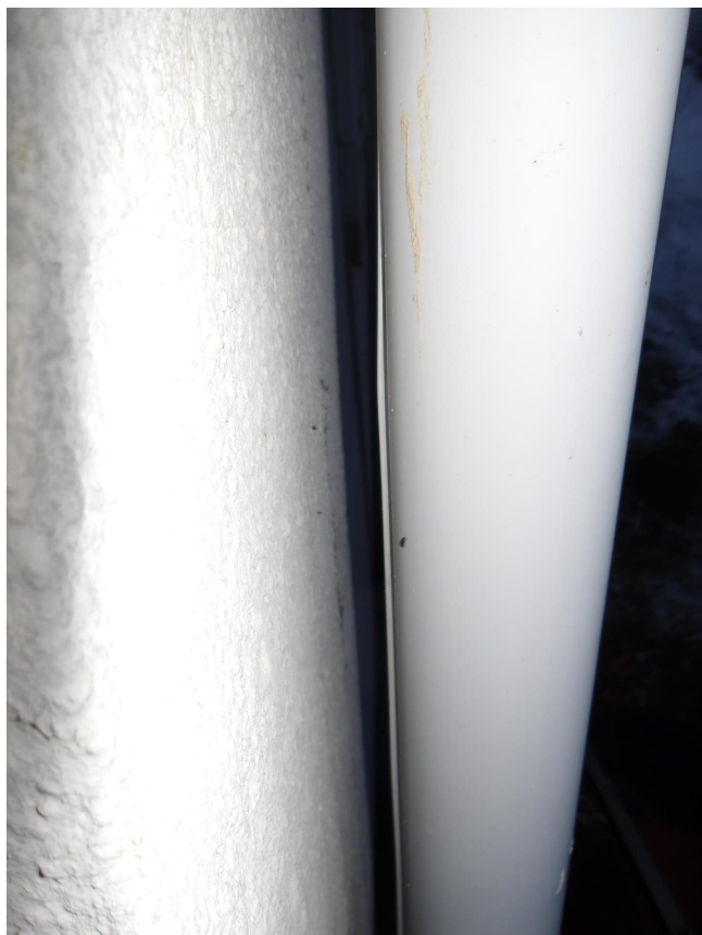
Skade i fals på nedløp.
