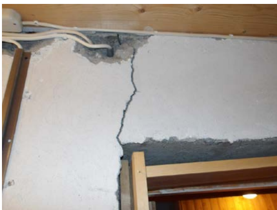
Skader på ytterveggen.
