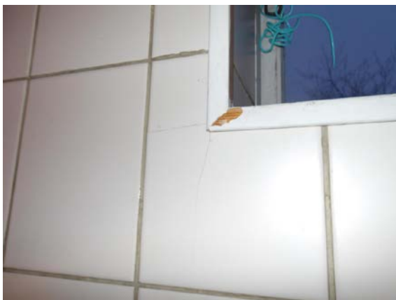
Sprekker i flis
