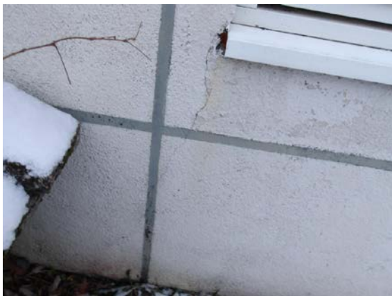
Sprekker i mur.
