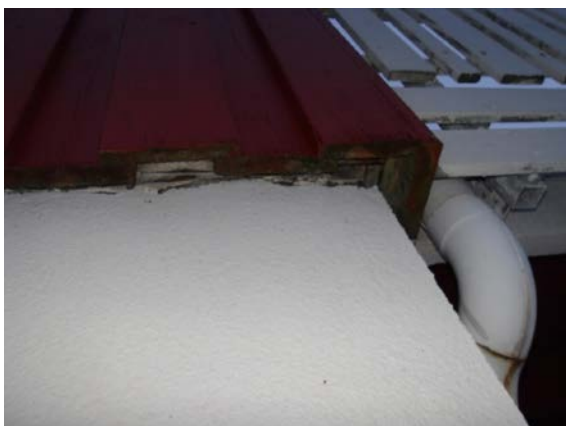
Råte i nedre kant av kledning.
