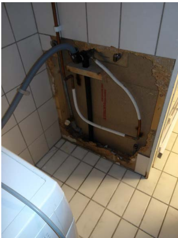
Ikke ferdig kledd.
