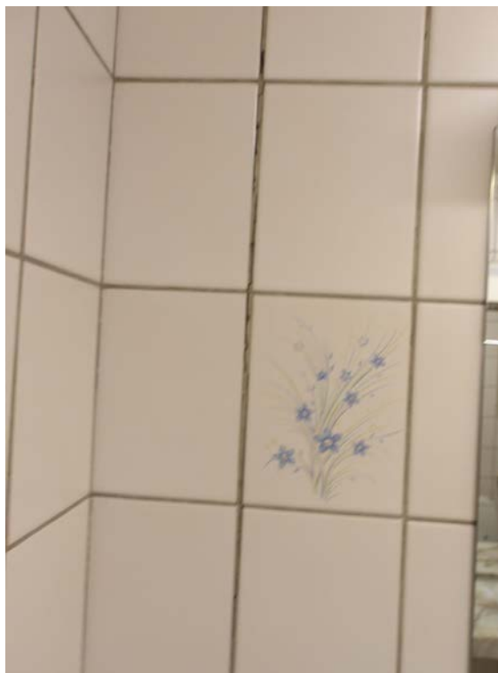
Sprekker i fuger
