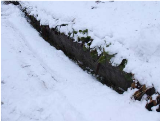
Mur er skadet og skjev.
