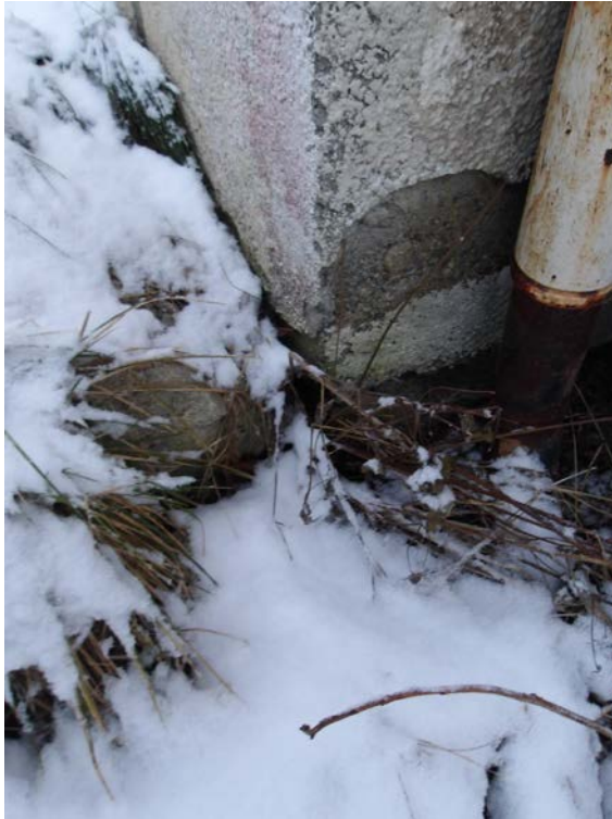
Avskalling av mur/pus
