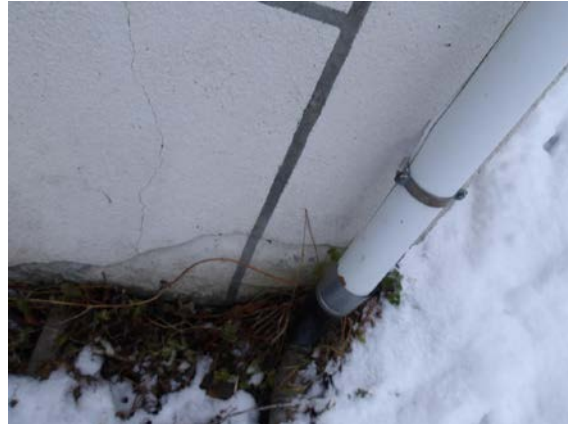
Sprekker og avskalling av mur.
