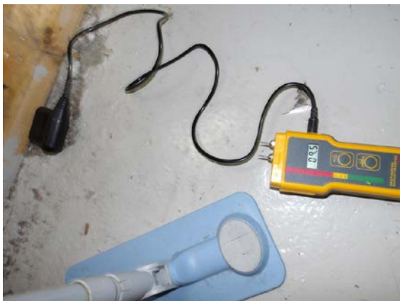
Fuktmåling bak dusjkabinett
