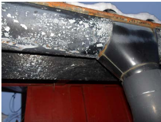
Noe rust på renner.
