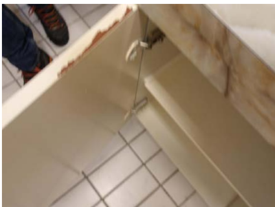
Skade på innredning.
