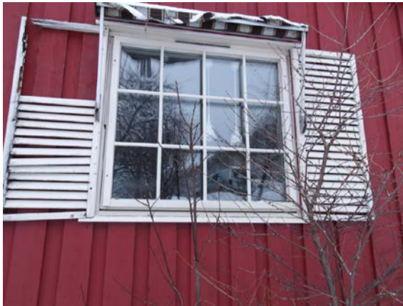
Vinduer fra 90-tallet . 3- lags isolerglas Skodder er råtne.
