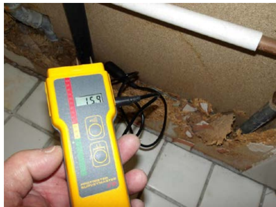
Fuktmåling på baksiden av vaskeservant
