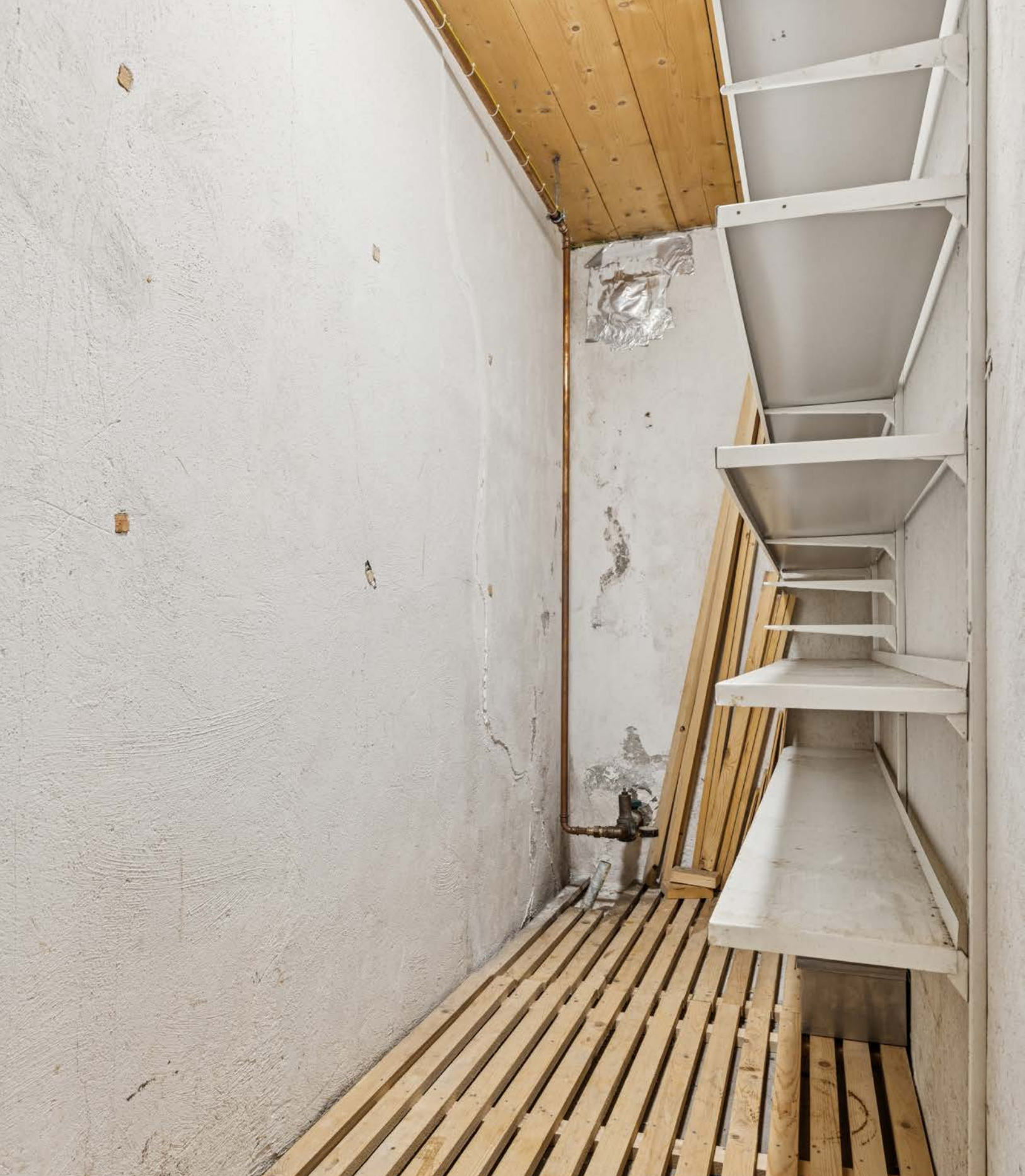
Vegghyller og åpen rørføring gir enkel tilgang til oppbevaring og vannsystem.
