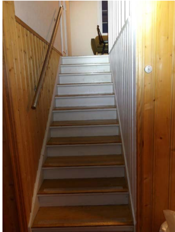
Kjellertrapp mangler håndløper på den ene siden.
