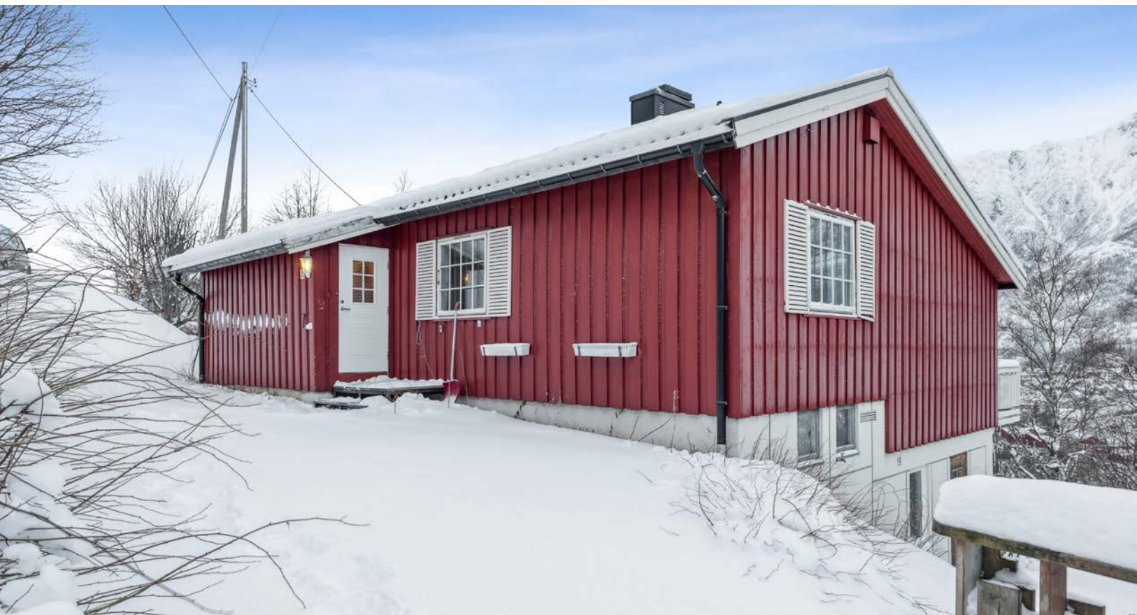
Yttervegger i tre med kledning av trebord, noen deler trenger utskifting grunnet råte.
