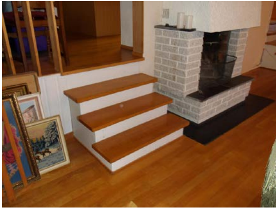
Innvendig trapp mangler rekkverk.
