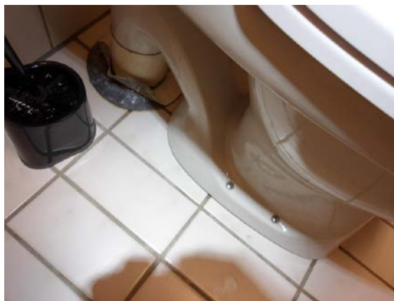
Krage rundt toalettavløpet har skader.
