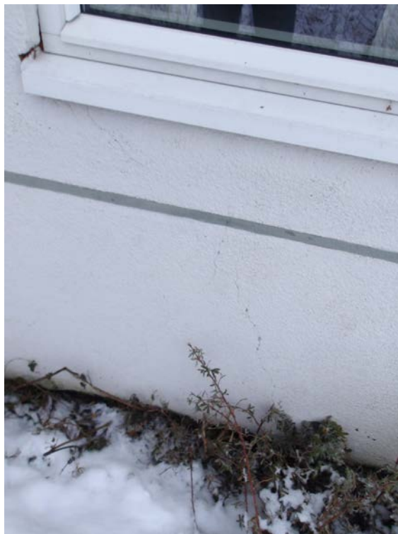
Sprekker i mur
