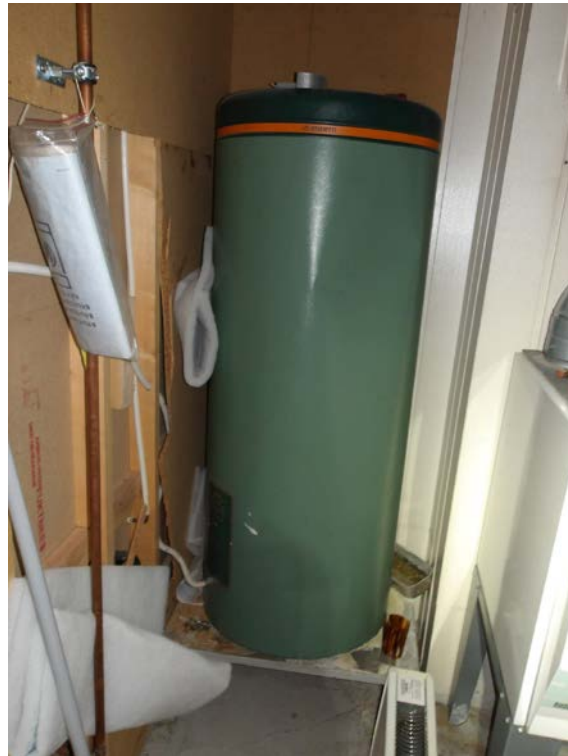
200 l varmtvannstank. Ukjent produksjonsår.
