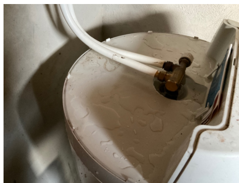
Lekkasje på Varmtvannstank
