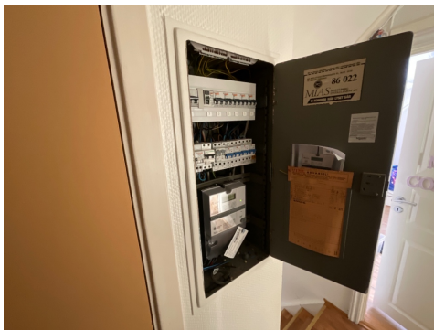
Sikringsskap i gang 2. etasje
