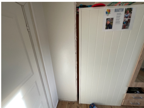
Ikke synlig pipevange i 2. etasje
