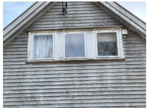
Råteskadede vinduer i 2. etasje
