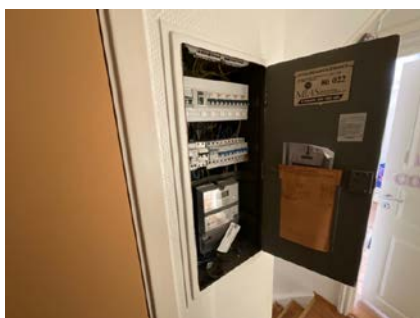
Sikringsskap i gang 2. etasje
