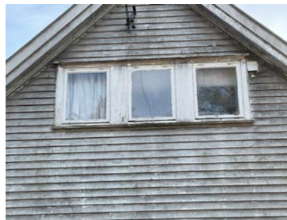
Råteskadde vinduer i 2. etasje
