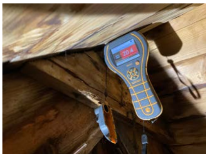
Fuktmåling på loft
