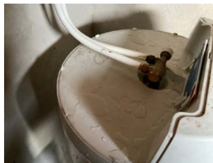
Lekkasje på Varmtvannstank
