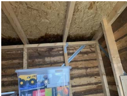
Fuktskade i yttertak.
