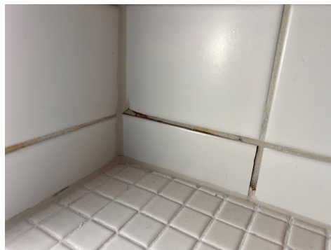
Sprekk i flisefuger i dusjsone
