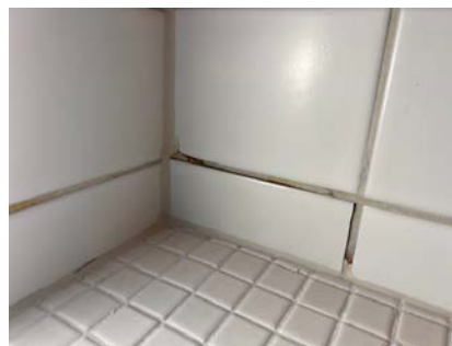
Sprekk i flisefuger i dusjsone
