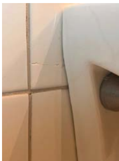
Sprekk i flis ved innfesting til toalett (begge sider)
