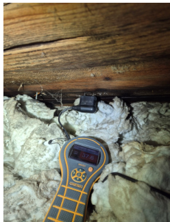
Målt høyde fuktverdier i undertak.
