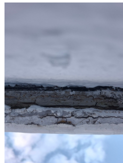
Ingen luftespalte bak kledningsbord.
