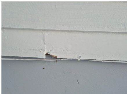
Råte i bunn av kledningsbord.
