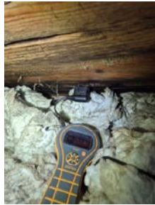
Målt høyde fuktverdier i undertak.
