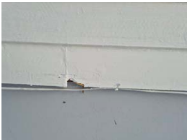
Råte i bunn av kledningsbord.
